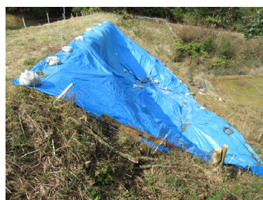
写真 1 下流面のすべり破壊(右岸側より撮影)
